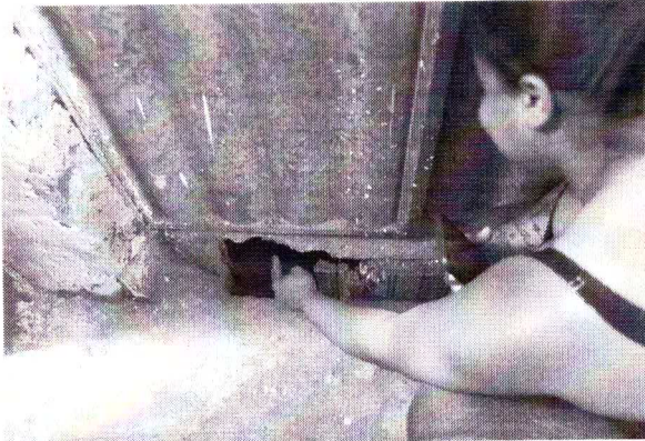
Rachaduras e a abertura do solo surgiram na residencial Vale do Mundau localizada no bairro
