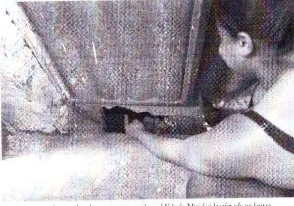
Rachaduras e a abertura do solo surgiram no residencial Vale do Mundau localizado no bairro
