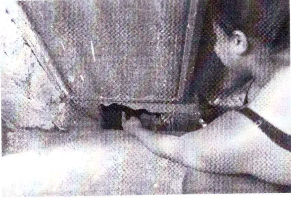
Rachaduras e a abertura do solo surgiram no residencial Vale do Mundau localizado no bairro
