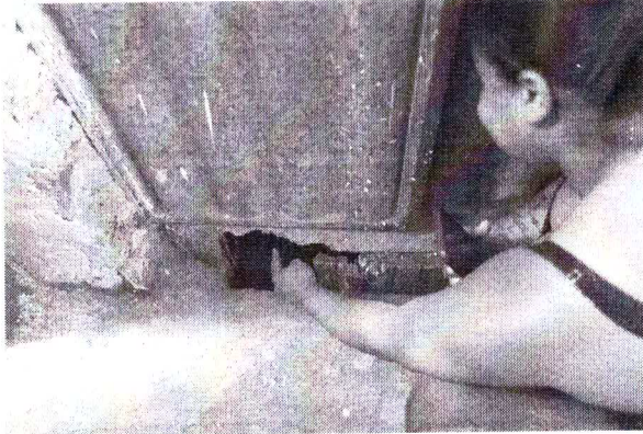
Rachaduras e a abertura do solo surgiram no residencial Vale do Mundo localizado no bairro
