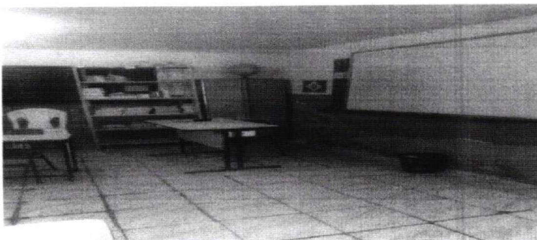
Creche Fumaça – Danos em paredes e pisos
