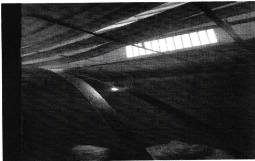
Forro danificado- Bolsa Família
