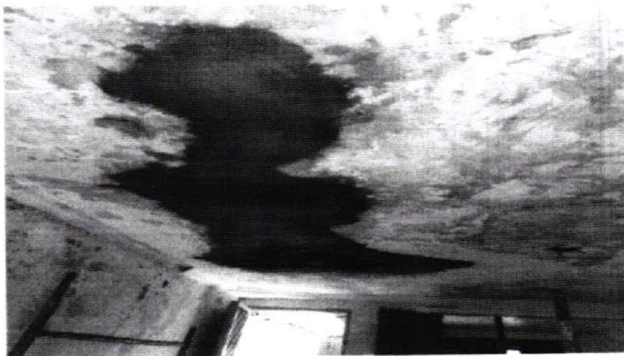
Infiltrações na sec de assistência social/ danos ao teto
