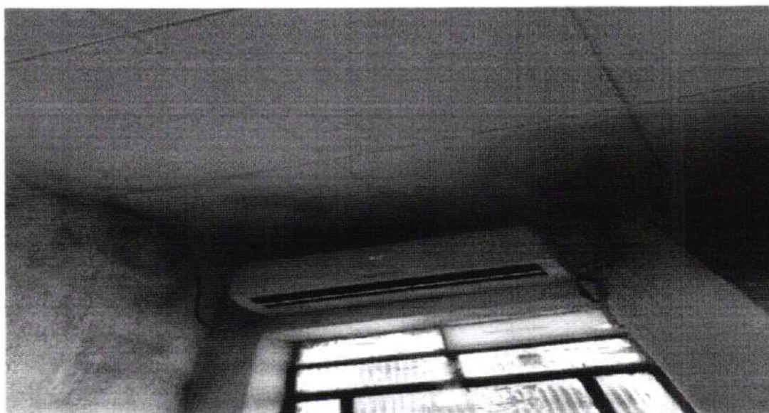
Infiltrações Descendentes/forro e pintura danificados
