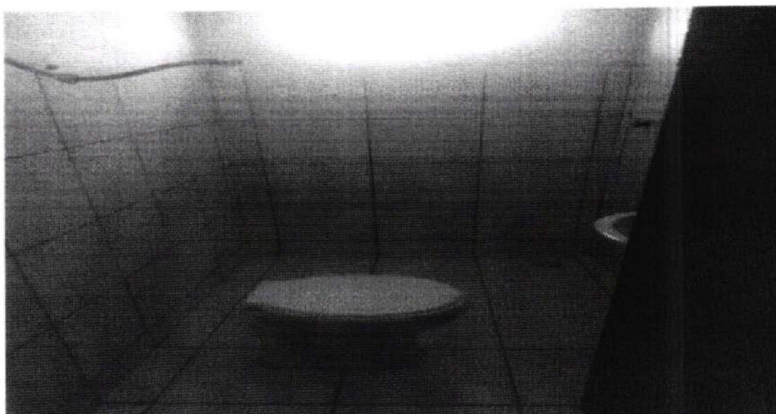
Inst sanitária danificadas
