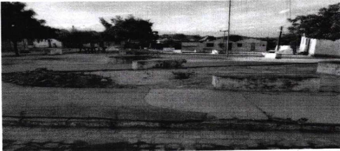
Praça Santa Cruz – Danos em pisos, revestimentos, iluminação
