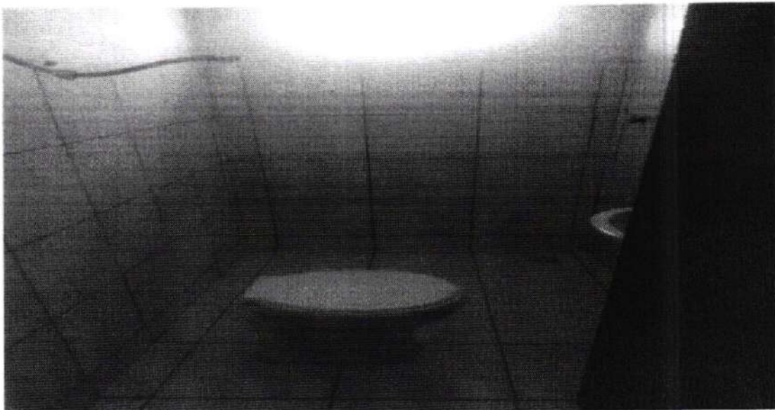
Inst sanitária danificadas
