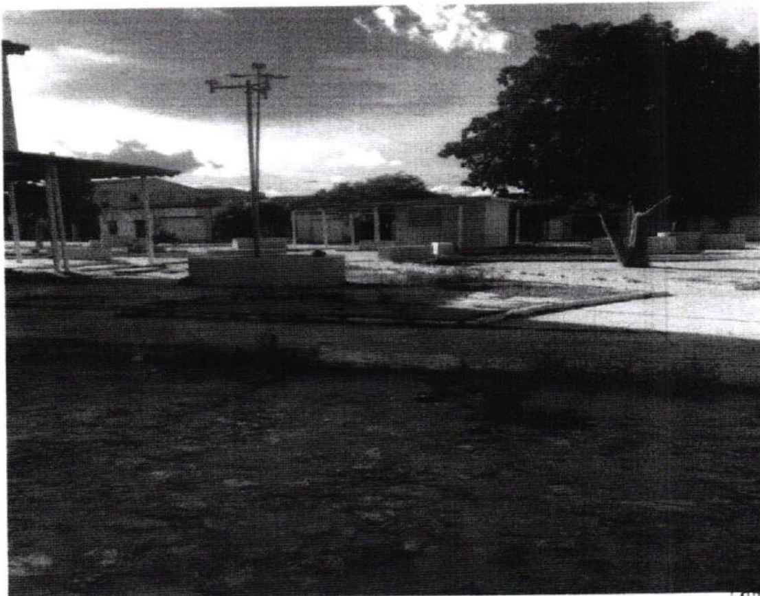
Praça Capiá – danos em pisos, iluminação, revestimentos
