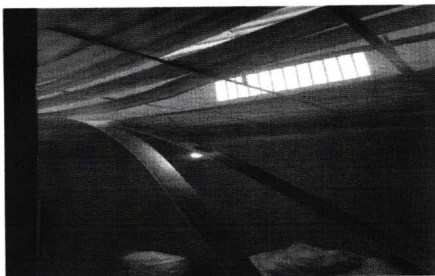
Forro danificado- Bolsa Família
